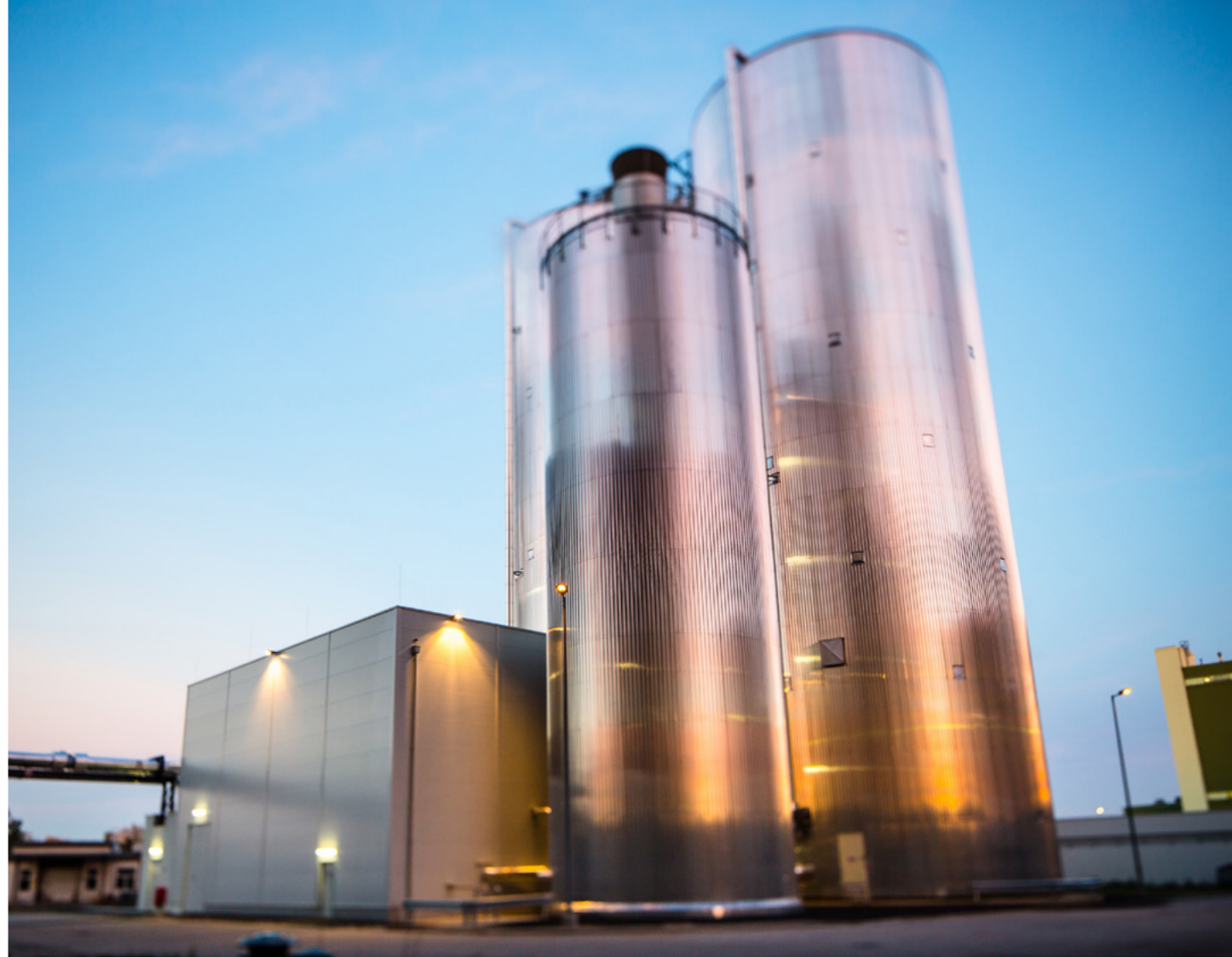
Wärmespeicher Simmering, © Wien Energie/Ian Ehm
